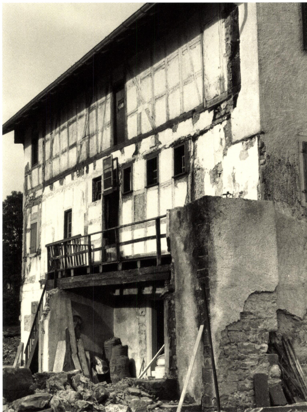
Abb. 5: Westfassade unmittelbar nach dem Abbruch des Schopfanbaus um 1950 (Foto Ritterhaus-Vereinigung Üriikon Stäfa). Die Oberfläche ist nicht einheitlich. Fassungen und Putzschichten, die auf diesem Foto sichtbar sind, wurden bei der Fassadensanierung abgetragen.
